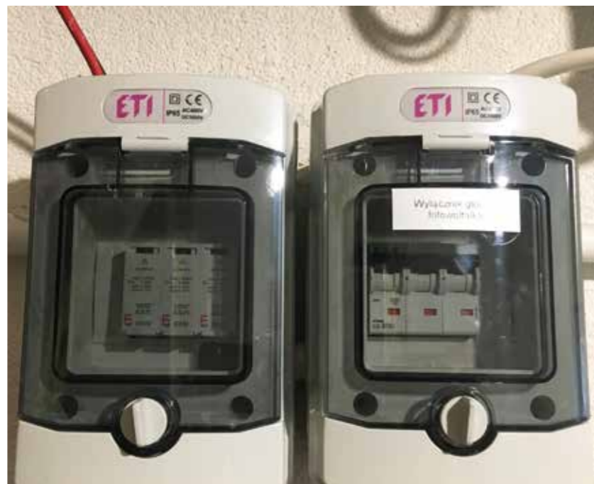
Zabezpieczenia przed przepięciami inwertera
